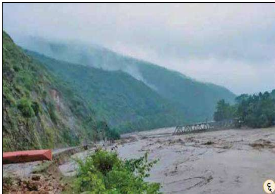
चित्र ५- १०२: सुनकोशी नदीमा आएको बाढीले शनिवार बिहान बगाएको खुर्कोटमा निर्मित सिन्धुली-रामेछाप जोड्ने सुनकोशीको पुल सचिन पोखरेल/गोरखा पत्र (२०८१-०६-१३)
